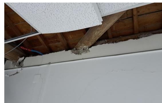
Κακή σύνδεση τοιχοποιίας με στέγη
